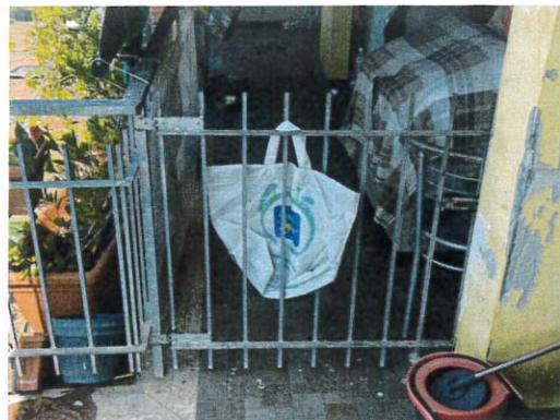
Foto 1 - cancelletto attualmente presente, da ripristinare per rendere indipendenti le due uu.ii
